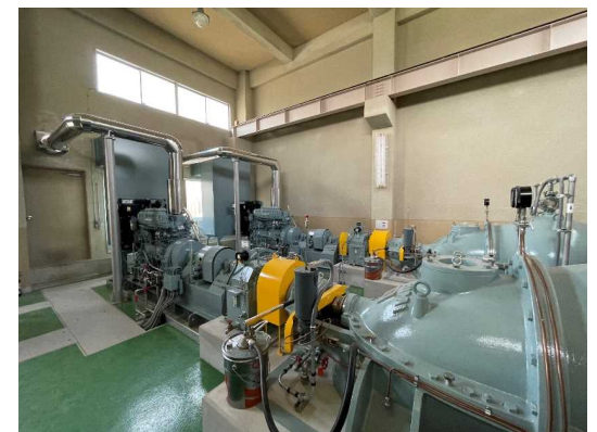
塩崎排水機場 (屋内)
