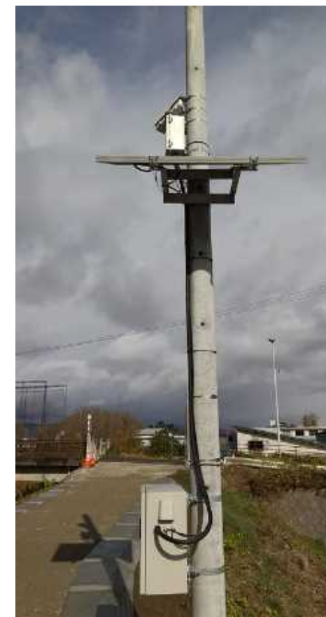
簡易型河川監視カメラ
