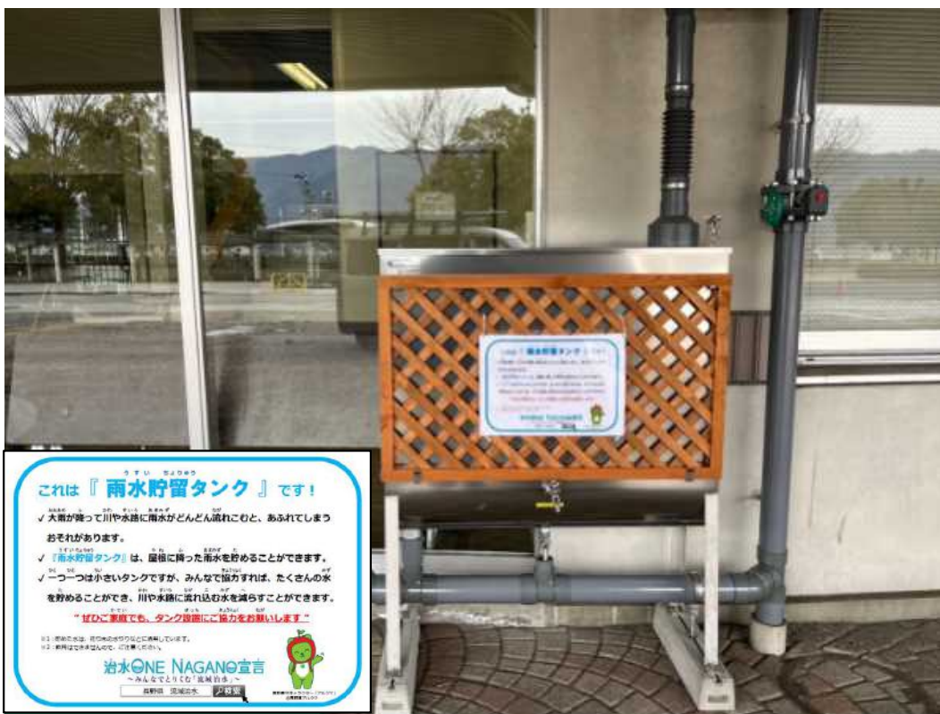
県有施設における雨水貯留タンクの設置 （ 県営上田野球場 ）
