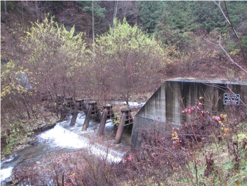
鋼製スリット谷止工（H28時点）
