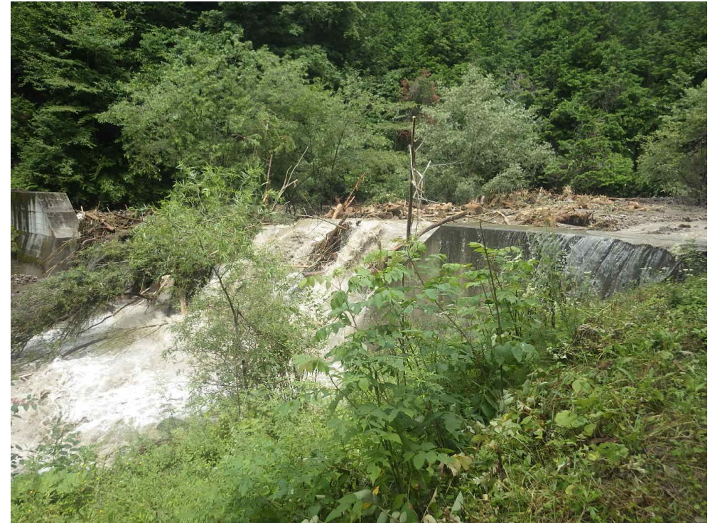
土石等の補足状況（R3.8時点）
