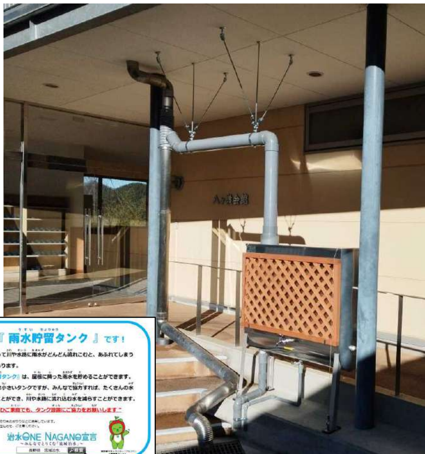
県有施設における雨水貯留タンクの設置 (長野県小海高等学校)
