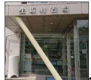
■雨水貯留タンク (生坂村役場)
