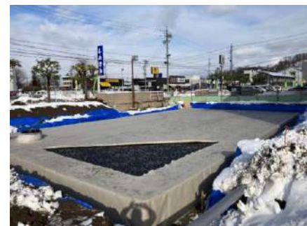
千曲警察署 雨水貯留浸透施設（地下貯留方式）
