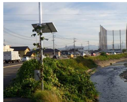
簡易型河川監視カメラ
