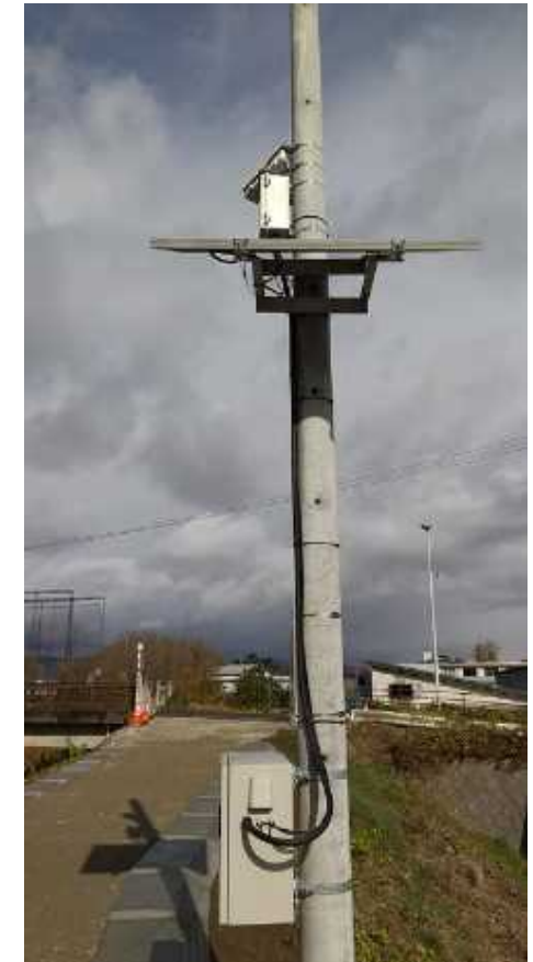
簡易型河川監視カメラ
