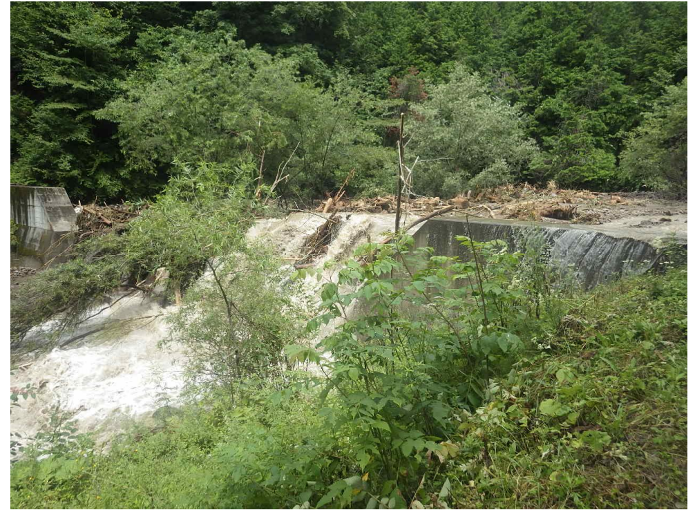
土石等の補足状況（R3.8時点）
