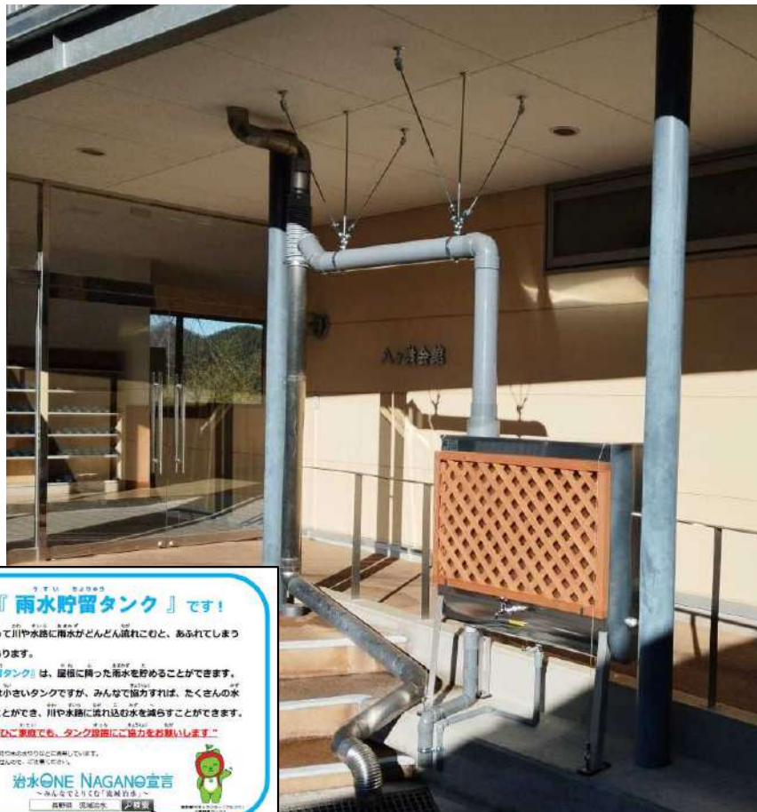
県有施設における雨水貯留タンクの設置 （長野県小海高等学校）
