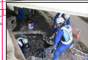
コンクリート樹周辺空洞化状況
