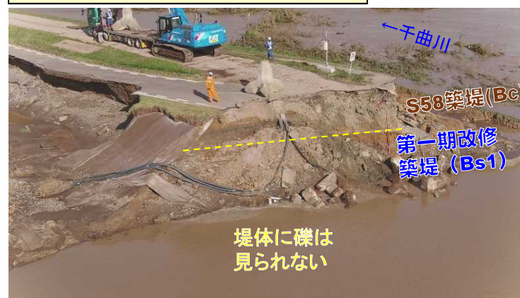
決壊部下流側川裏の状況
