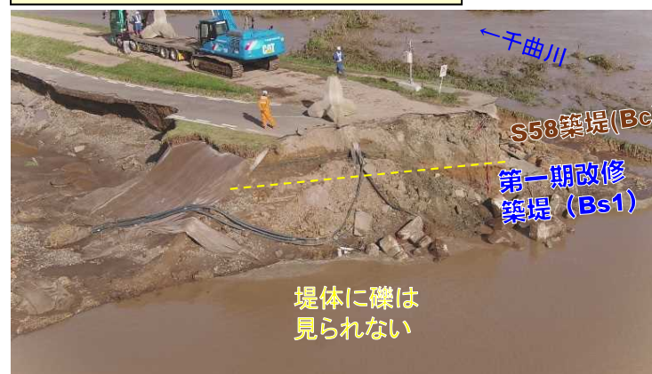
決壊部下流側川裏の状況
