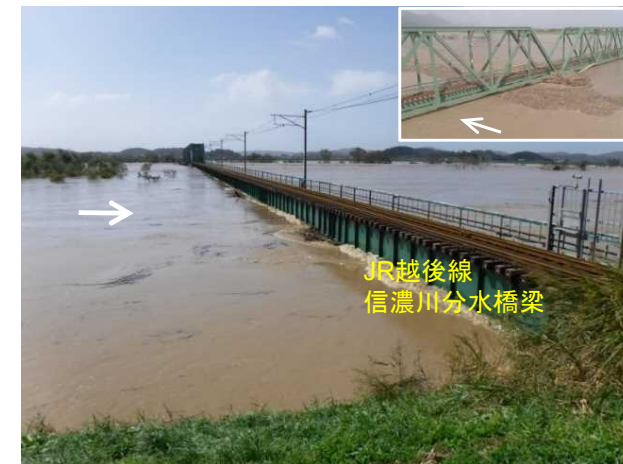
JR越後線信濃川分水橋梁付近の状況 (10月13日11時55分時点)
